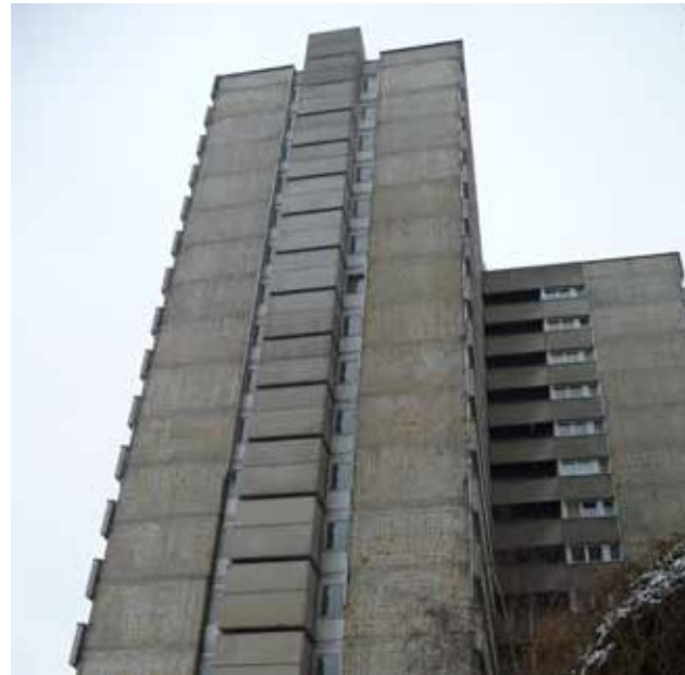
Abb. 1 In diesem Frankfurter Studentenheim wurde es hinter den nackten Stahlbetonwänden ungemütlich kalt, nachdem die nur drei Zentimeter dünne Wärmedämmung im Zuge der energetischen Fassadenanierung über den Winter kurzzeitig abgenommen worden war.
